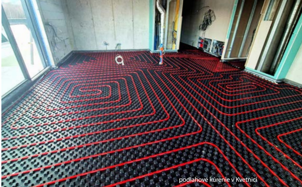
podlahové kúrenie v Kvetnici
